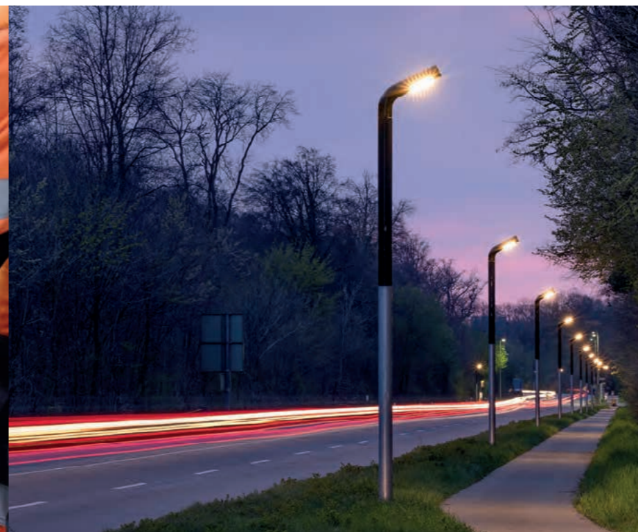
Jede Leuchte besitzt eine Steuereinheit, welche den vorhandenen Strom im Verlauf der Nacht optimal nutzt.
